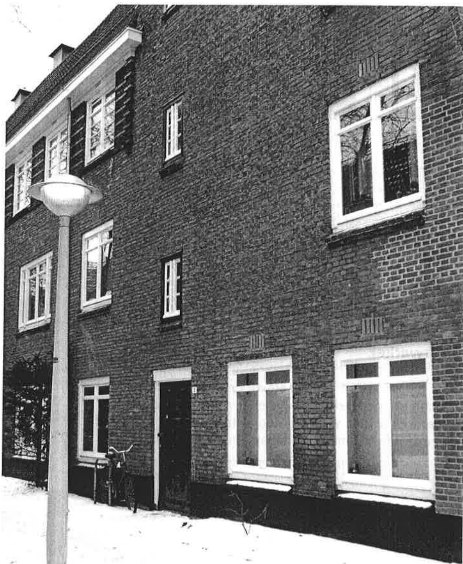
Gerestaureerde gevel met originele ventilatiesleuven. (foto: Y. Pelser)
