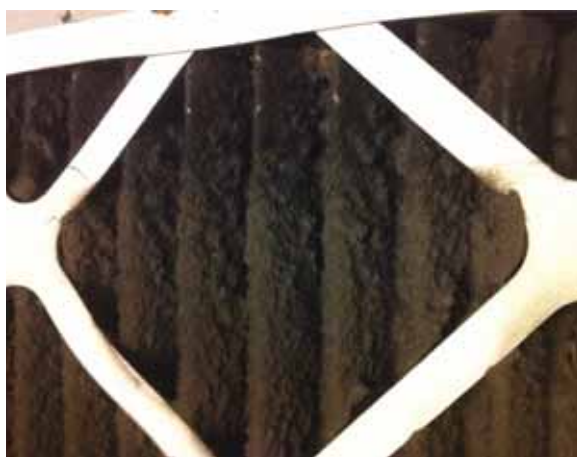
Figuur 2. Een G4-paneelfilter in de centrale luchtbehandelingskast van een basisschool: na twee jaar standtijd bedekt met een dikke laag roet.
